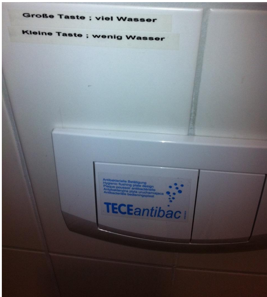
Hinweis-Aufkleber für Wassereinsparungen am WC
