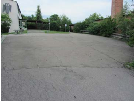
Belagsschäden im nordwestlichen Pausenhof
