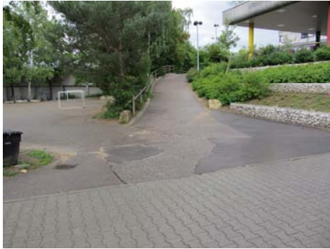
Belagsschäden im Bereich Realschule
