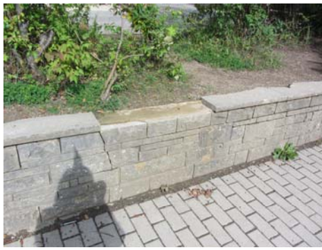
Natursteinmauer mit Reparaturbedarf
