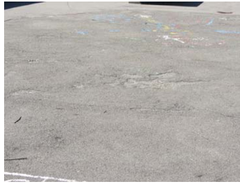
Schadstellen im Asphaltbelag
