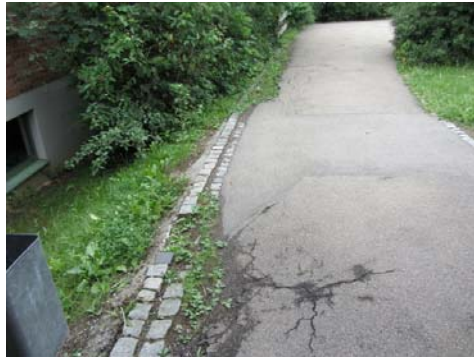
Risse im Wegebelag
