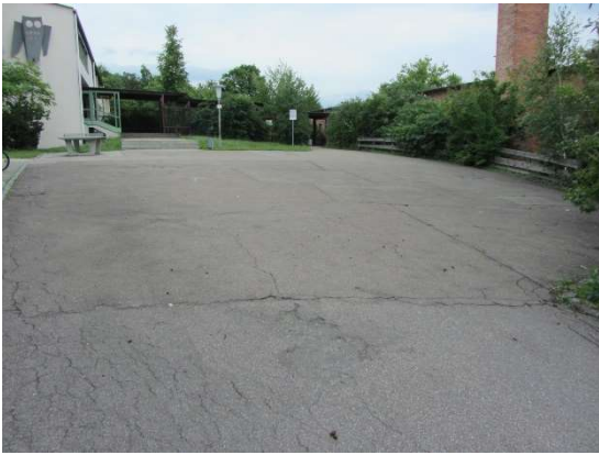
Belagsschäden im nordwestlichen
