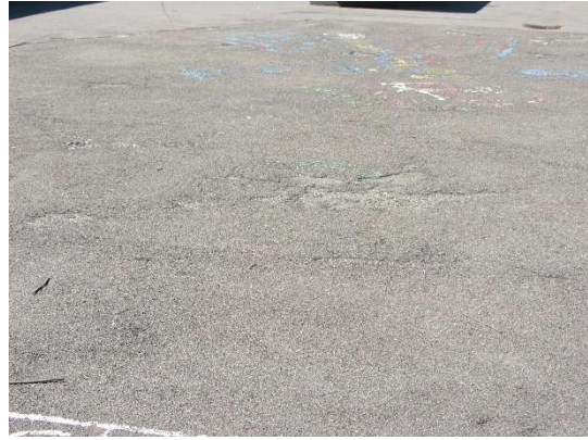
Schadstellen im Asphaltbelag
