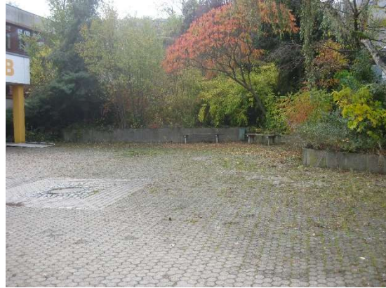
Sanierungsbedürftiger Pflasterbelag Westseite
