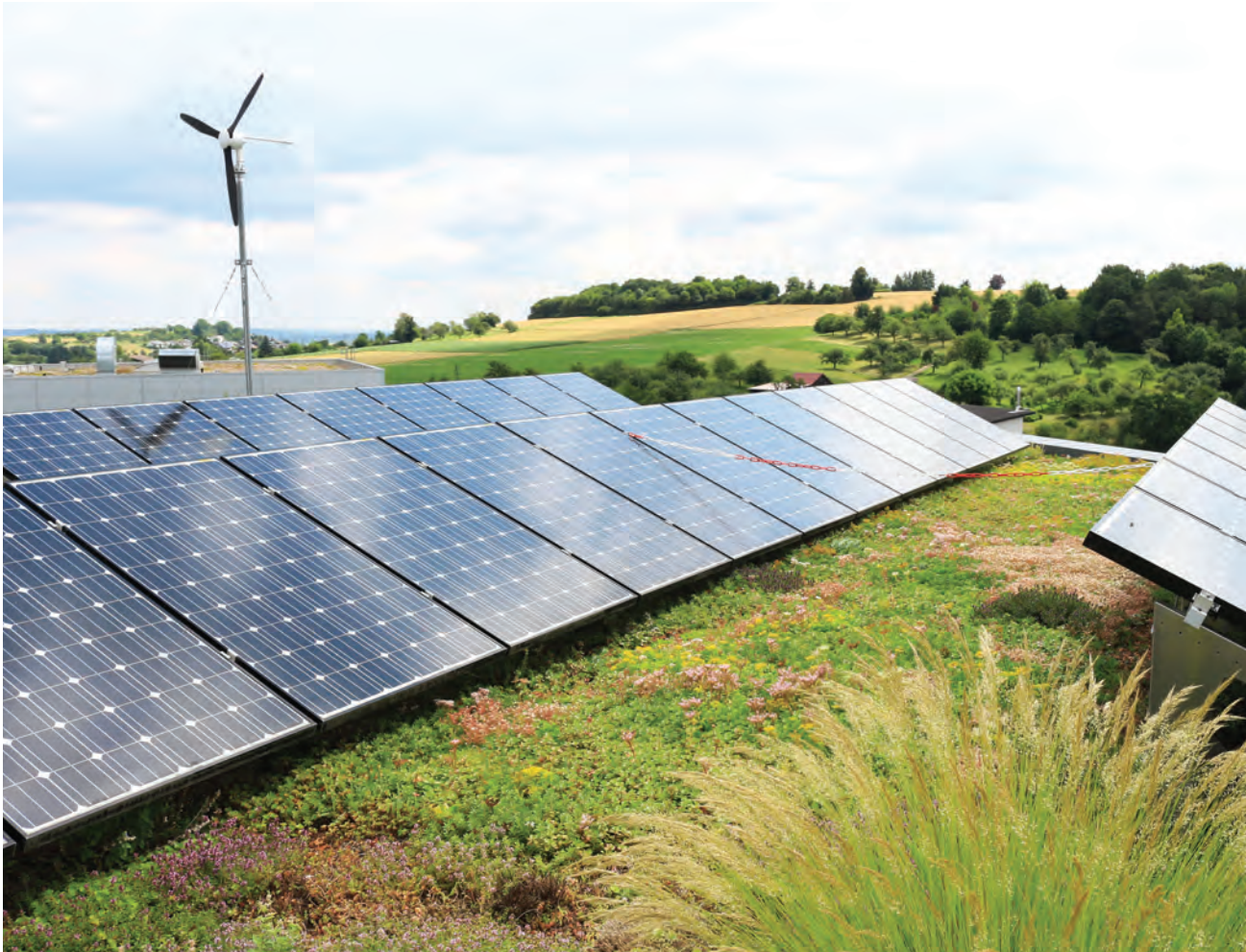
Abb. 12 Solaranlage mit Dachbegrünung, Firma ZinCo
