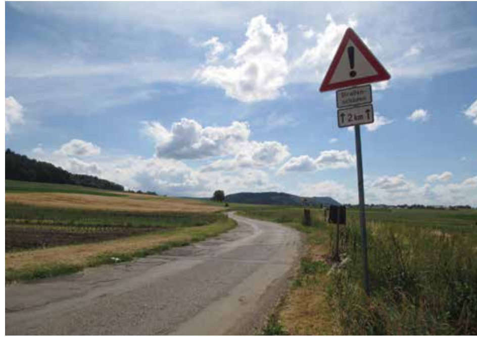
Der Dauerwangweg weist aktuell viele Schäden - v.a. Schlaglöcher und Risse im Randbereich - auf.
