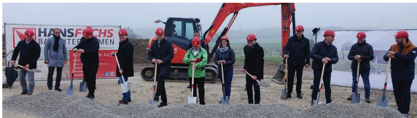
OB Thilo Rentschler startete gemeinsam mit Vertretern des Ortschaftsrats, der Bauverwaltung und den am Neubau beteiligten Firmen die Realisierung der Kita. Foto: Stadt Aalen
