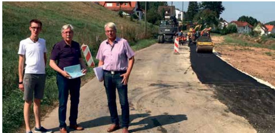
Yannik Beerhalter, Jürgen Opferkuch und Albert Schiele (v.li.) erläuterten den Baufortschritt an der Ortsdurchfahrt Waiblingen. Foto: Stadt Aalen
