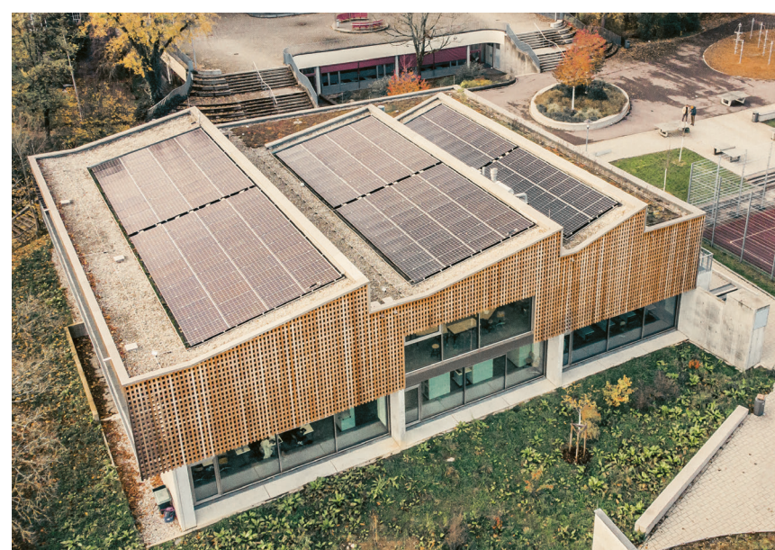
Die PV-Anlage auf dem Fachklassentrakt des Schubart Gymnasiums. Foto: Stadt Aalen
