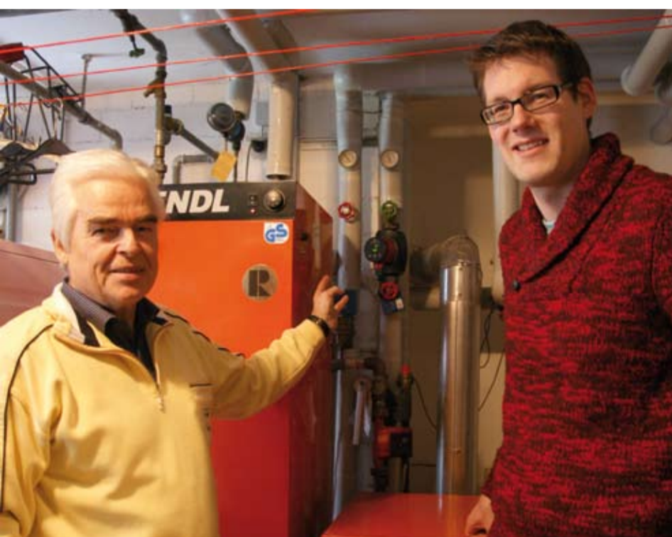
Dr. Dietrich Braasch zeigt Klimaschutzmanager Helke Neuendorff die neue Heizungspumpe.
